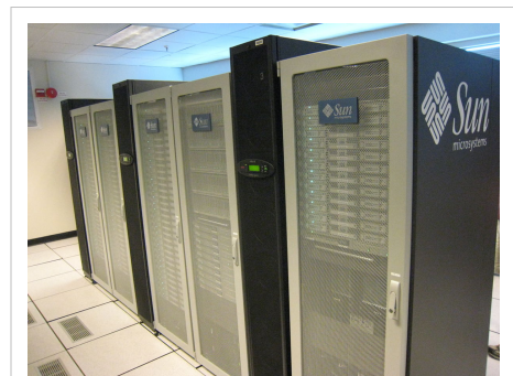
Armadi in una server farm: da notare le torri nere tra gli armadi, contenenti i dispositivi di condizionamento
